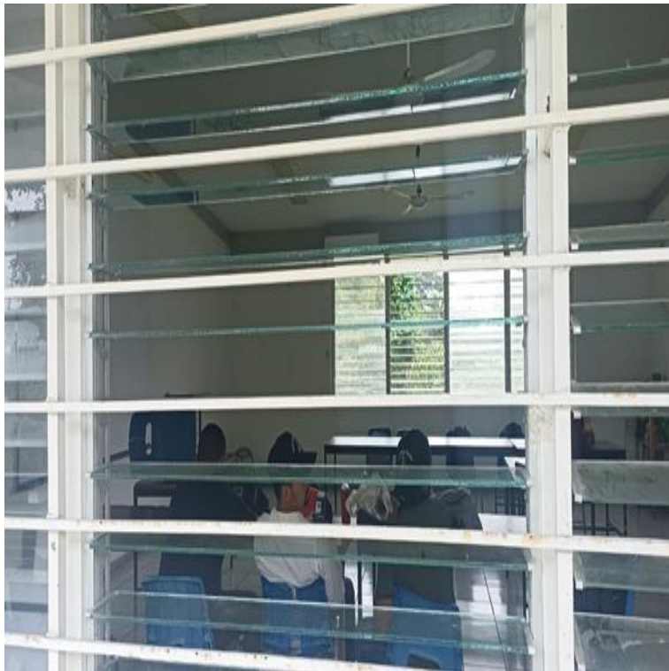
Anexo 19. Ventanas instaladas de la FMEA.
