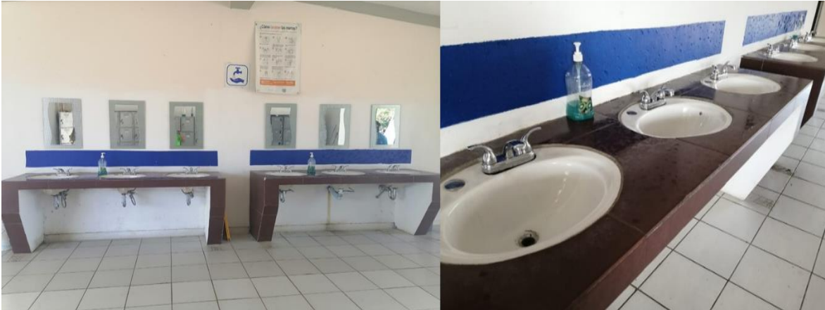
Figura 17: Instalación de espejos y llaves de agua en los baños de la Facultad Maya.
